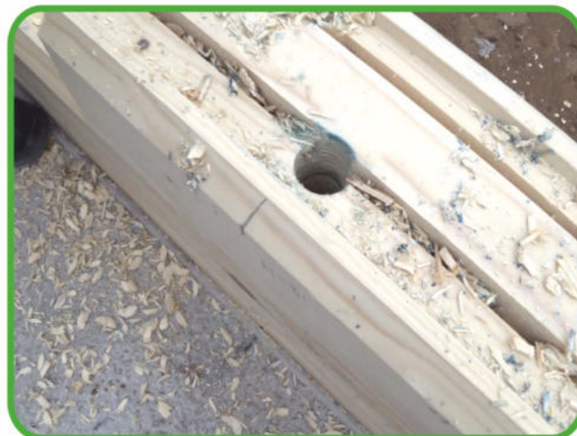
Вертикальный канал для электропроводки
